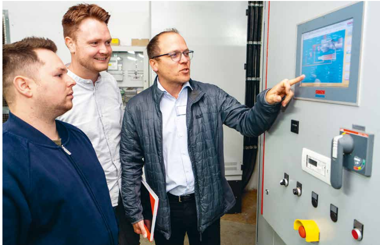
Wichtige Energieeffizienz-Maßnahme: EvKB-Betriebstechnik-Leiter Dirk Eisberg (r.) erläutert Matthias Matuszczak (l.) und Patrick Lippek ein Blockheizkraftwerk in Gilead I.
